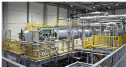
10MWの水電解装置
