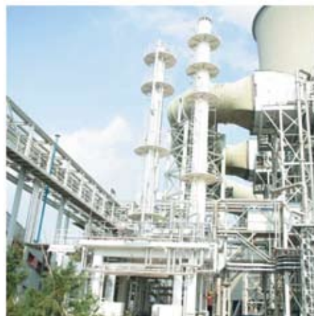
◎図5 華能北京熱電所のCO 2 回収装置
