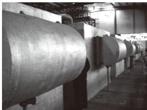
◎図4 発電所用の多段フラッシュ型海水淡水化装置（3000m 3 /d）
