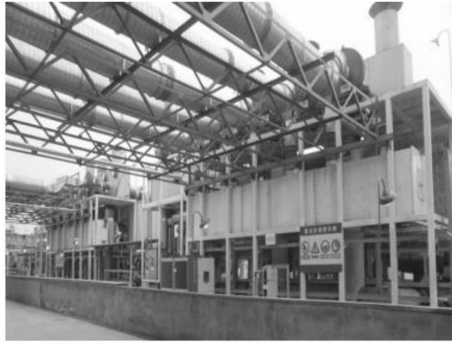
図表153 某カラー印刷工場の再生式固定床式粒状活性炭吸着装置
