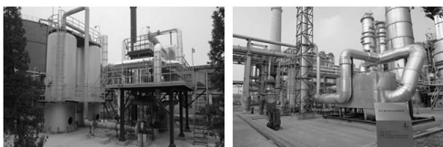
a) 污水处理場漏出消失排ガス処理装置 b) 芳香族炭化水素タンク地区排ガス処理装置
