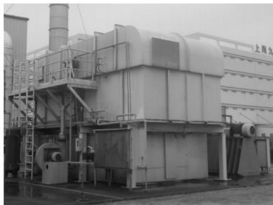
図表154 某雑誌印刷工場の蓄熱式直接燃焼炉浄化装置
